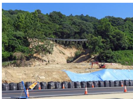
広島呉道路が崩れ、ガードレールだけにその下の呉線・水尻駅付近は土砂で埋没
