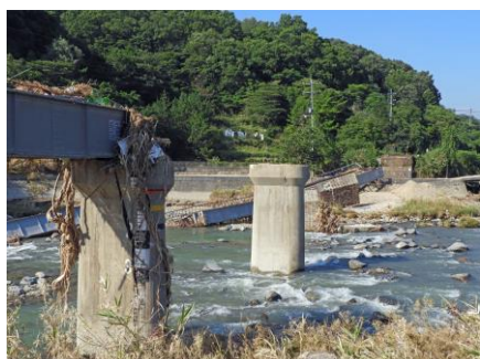
芸備線の第1三篠川橋梁が流出
